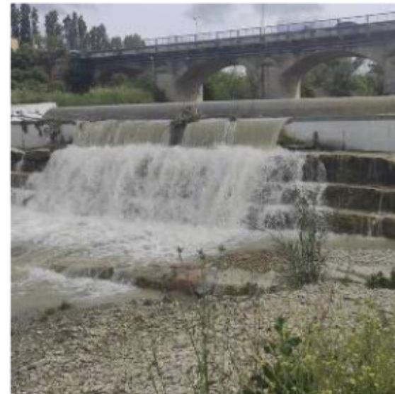
La situazione della diga sul Conca ieri, a causa delle fortissime piogge. L'allerta meteo prosegue anche per la giornata di oggi
